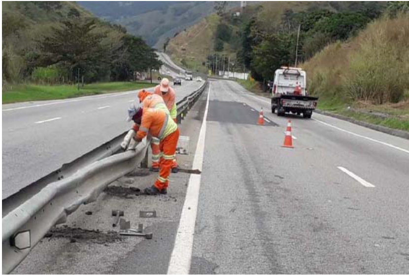
Foto 3 – Dispositivo de Segurança – Km 8+600 Norte
