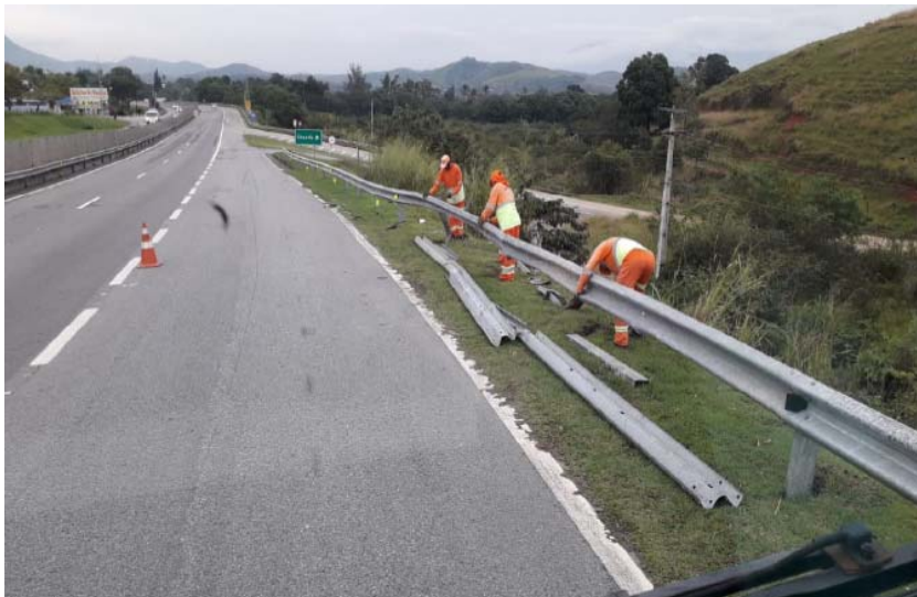
Foto 4 – Dispositivo de Segurança – Km 15+200 Sul
